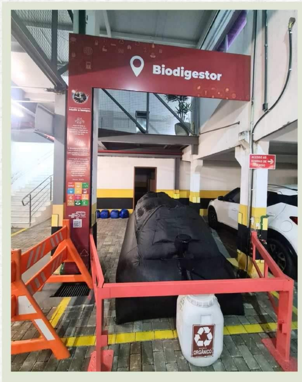
Fig. Biodigestor instalado na sede SEBRAE/RN, 2023
